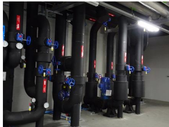
須要溫水循環pump 作溫水的加壓
