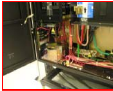
主電源盤內部安裝配置
