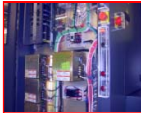
控制盤內安裝配置
