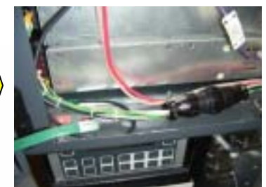
PM 端 UPS 導入接線位置
