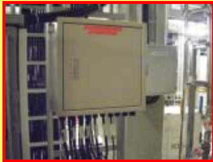
增設 UPS 控制電源箱
