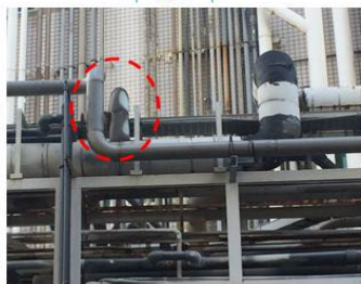
南電5廠蒸氣進入點
