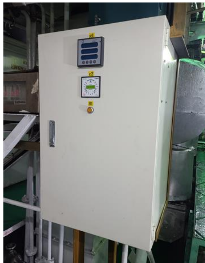
發電機與岸電解並聯裝置
