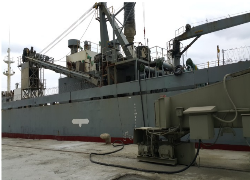
亞泥三號 花蓮港 岸電裝貨
