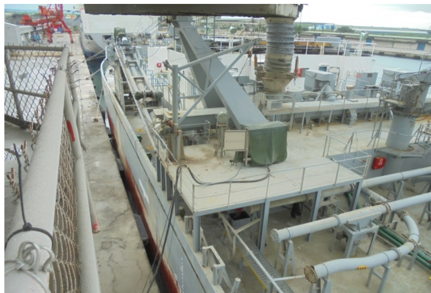
亞泥六號 花蓮港 岸電裝貨
