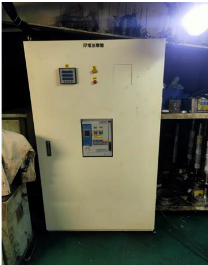
發電機與岸電解並聯裝置
