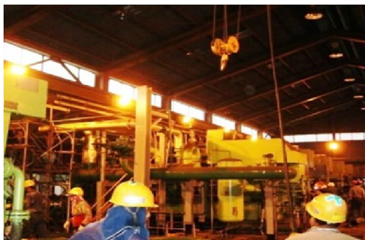
圖 11. 工廠中空壓站燈具安裝的位置產生強烈眩光
