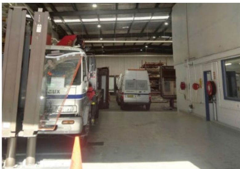
圖 61. 德高集團倉庫儲存區照明改善後照片
