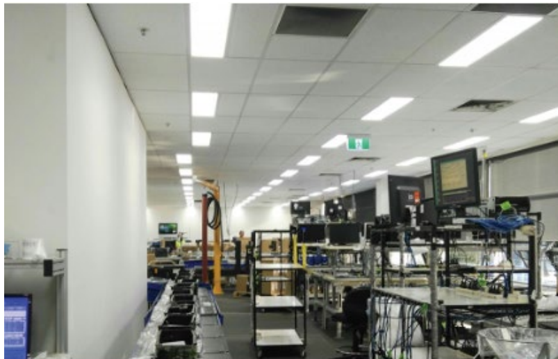
圖 58. 廠房區域置換為 LED 平板燈後照片
