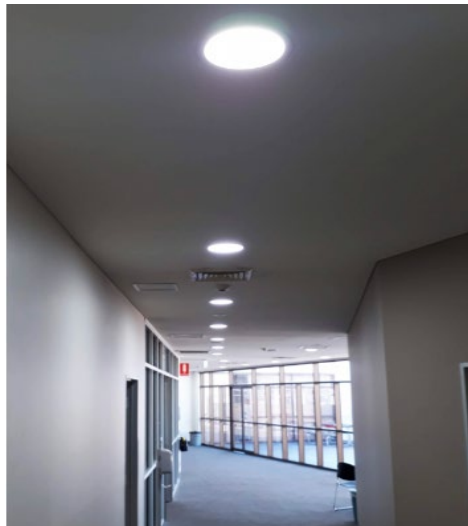
圖 49. 圖書館所換 LED 燈後走廊照片
