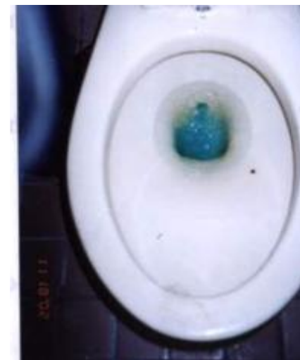
低水箱馬桶測漏—大漏及嚴重漏水
