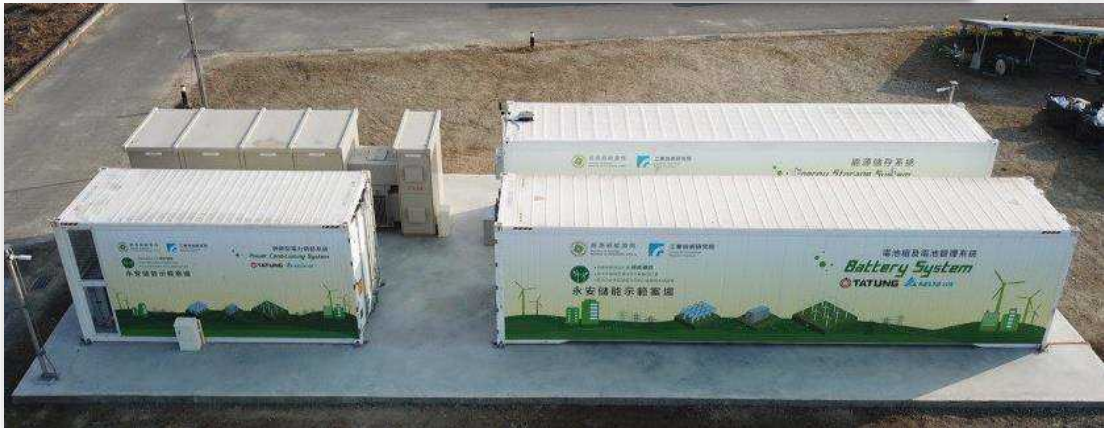
高雄永安儲能1000kW/1200kWh
