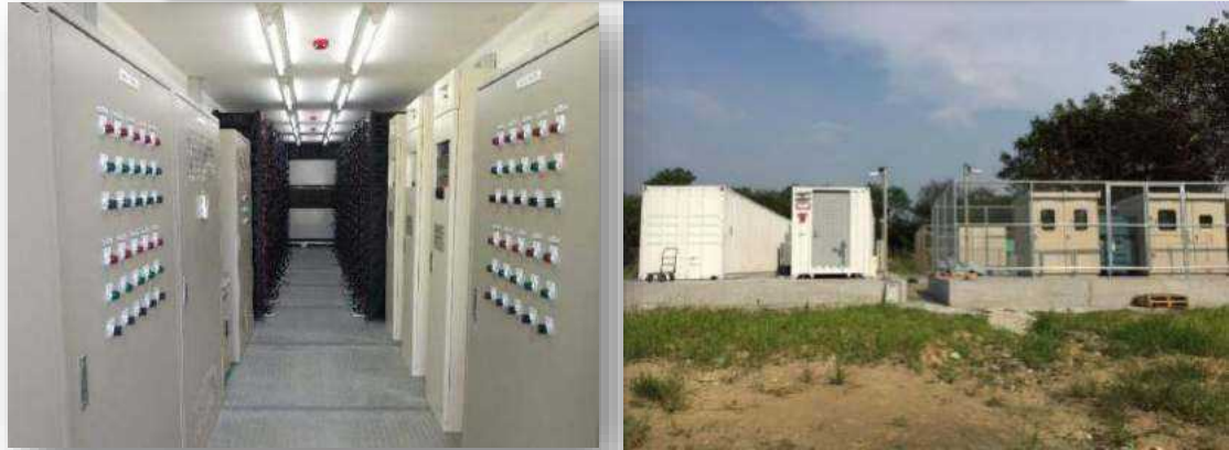
沙崙綠能旗艦儲能1000kW/800kWh
