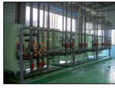
工程螺絲製造廢水脫鹽回收 (450 m 3 /d)
