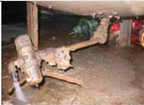
空氣桶下方祛水洩漏
