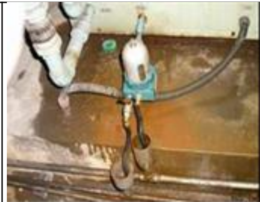
浮球式祛水器排水洩漏
