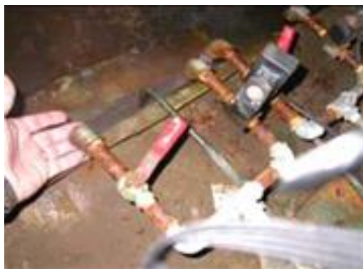
電子式祛水器排水洩漏
