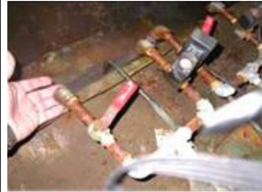
電子式祛水器排水洩漏
