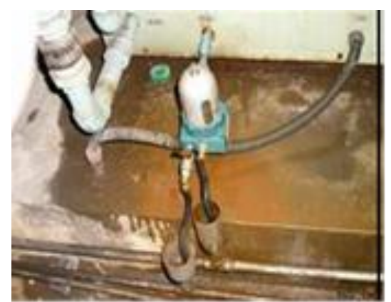
浮球式祛水器排水洩漏
