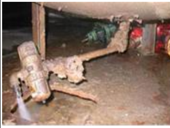
空氣桶下方祛水洩漏
