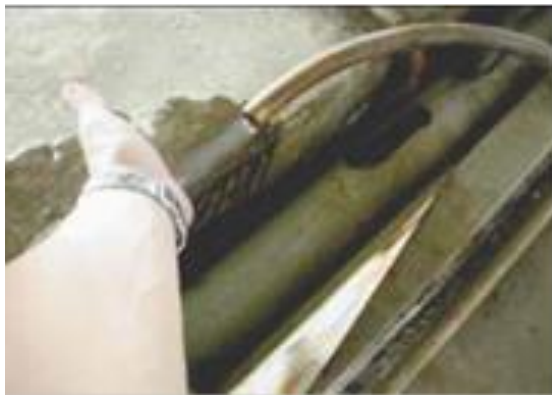
離心式中間段祛水洩漏
