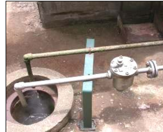
倒筒式卻水器排水洩漏
