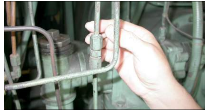
管路接頭不良造成的洩漏
