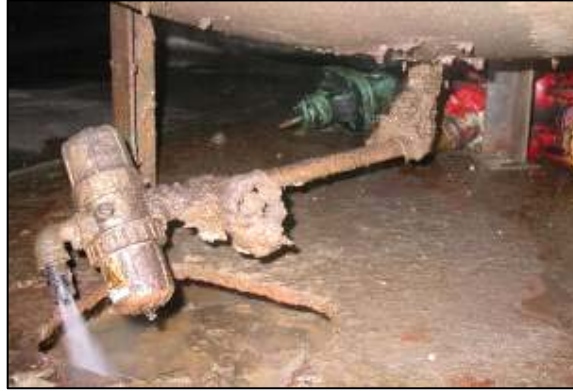
空氣桶下方卻水洩漏
