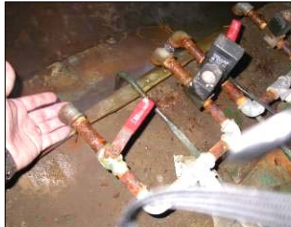
電子式卻水器排水洩漏
