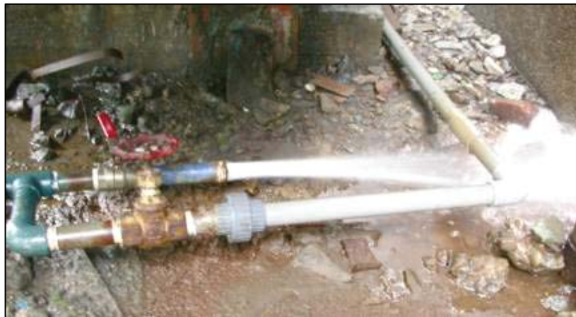
乾燥機的冷凝水排放洩漏
