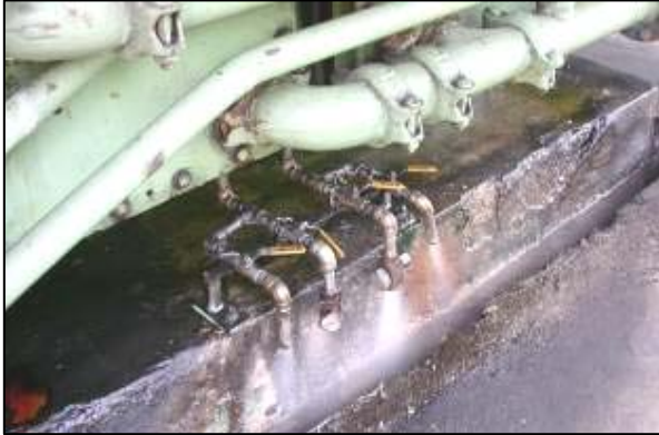
離心式中間段卻水洩漏
