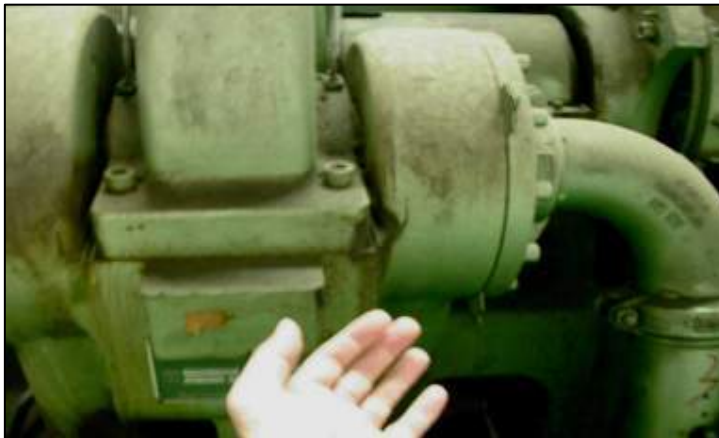
空壓機的內部洩漏
