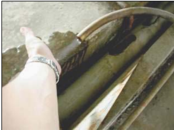
離心式中間段卻水洩漏
