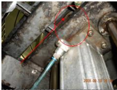
圖十八、疊箱機垂直氣壓缸漏氣
