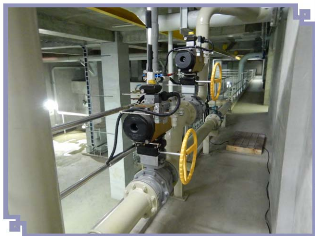
▲ 雨水處理及貯留設備管線
