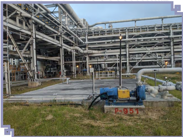
▲ Flare 區雨水回收槽
