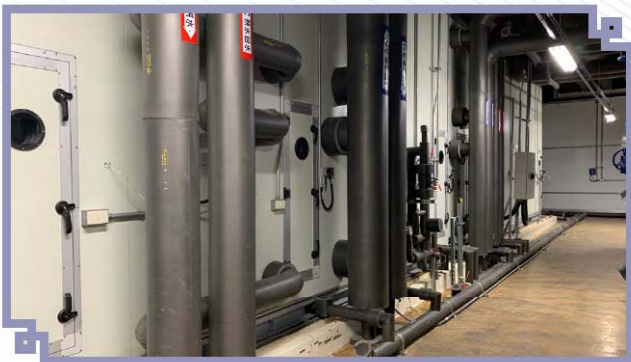
▲外氣空調箱 MAU 冷凝水回收
