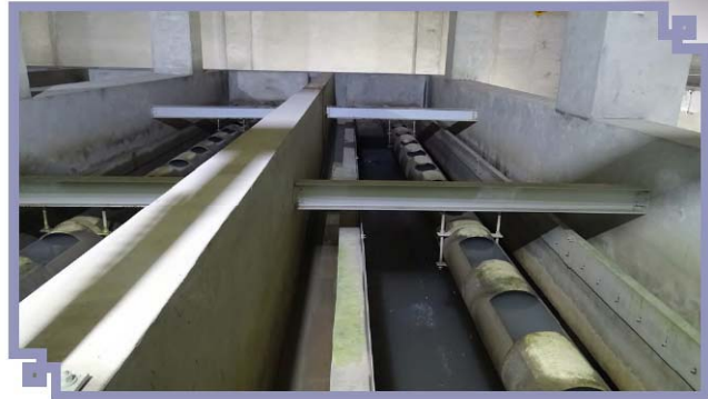
▲ 圳水處理回收設備
