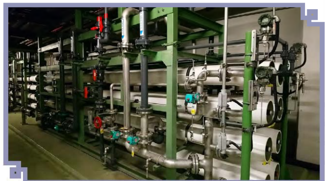
▲ LOW DI RO 增設
