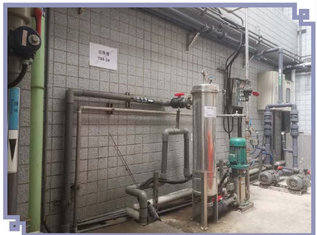
▲ 雨水回收前處理過濾設施
