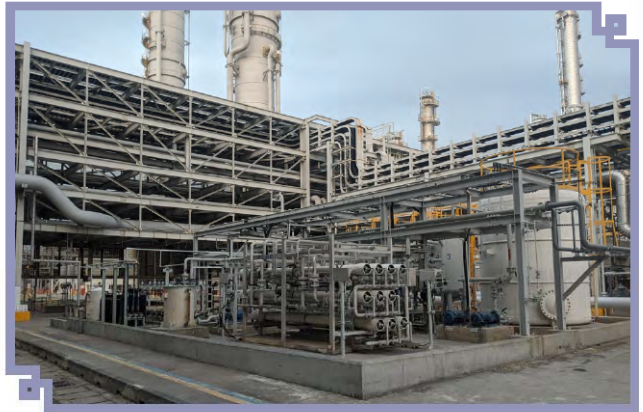
▲冷卻排放水第二套 MMF+RO 處理設備
