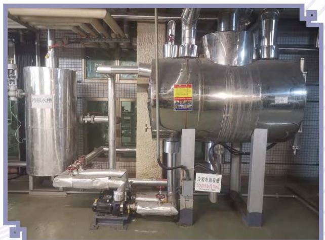
▲ 鍋爐冷凝水回收
