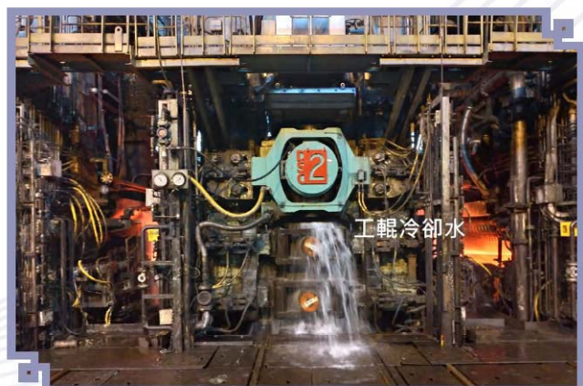
▲工輥冷卻水於長時間未軋時自動修正水量
