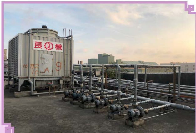
▲汰換冷卻水塔整合冷凍系統
