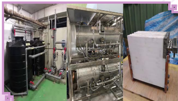
▲ 研磨製程水回收設備 (左) 淨水收集槽 (中) 研磨水過濾機 (右) 微米陶瓷
