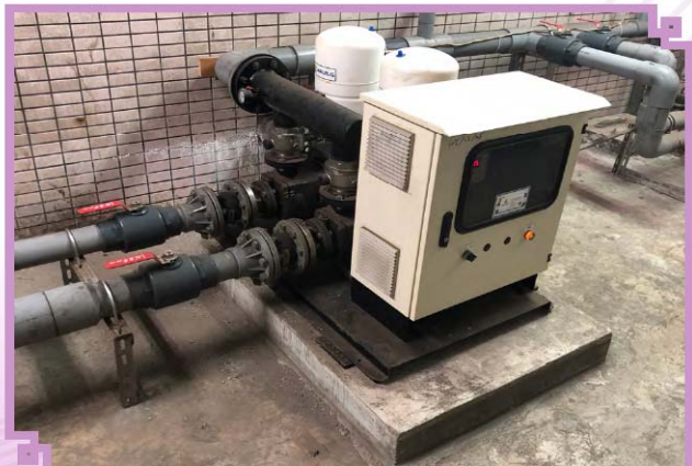
▲自來水電腦變頻恆壓 - 交替並列泵浦
