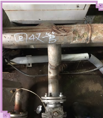
▲ 自行節水措施—冷卻水回收管
