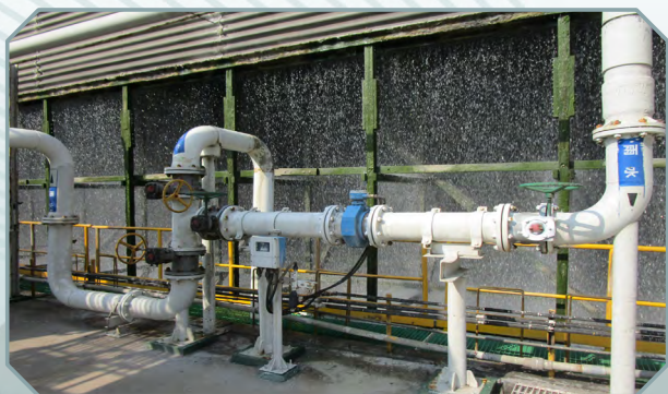
▲全廠製程區雨水回收 - 回收低污染雨水，脫除二氯乙烯後回收至水塔再利用
