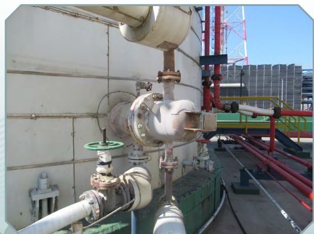
▲ 槽區冷凝水回收
