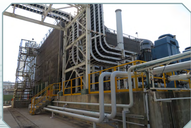
▲ 利用雨水貯留池 Z-070 清汙分流回收至冷卻水塔
