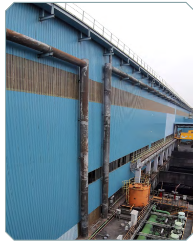
▲ 廠房屋頂雨水回收管
