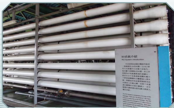
▲ 廢水純化場 RO 逆滲透設備
