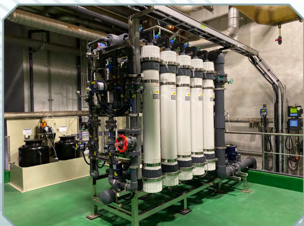
▲切割研磨排放水回收系統
