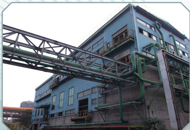
▲ RO 濃縮水回收管線
