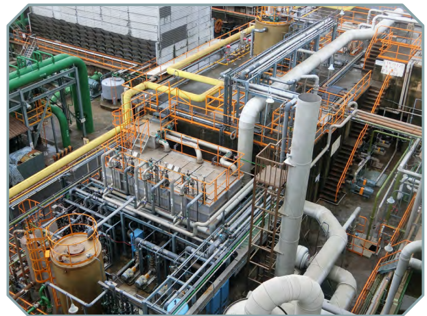
▲ MBR 廢水處理場
