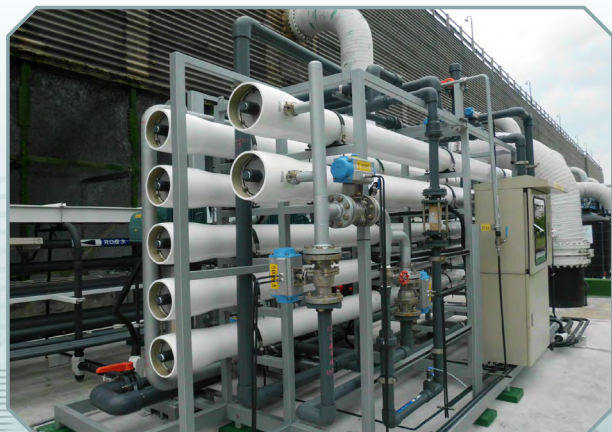
▲ 冷卻水塔排放水回收 -RO 區
