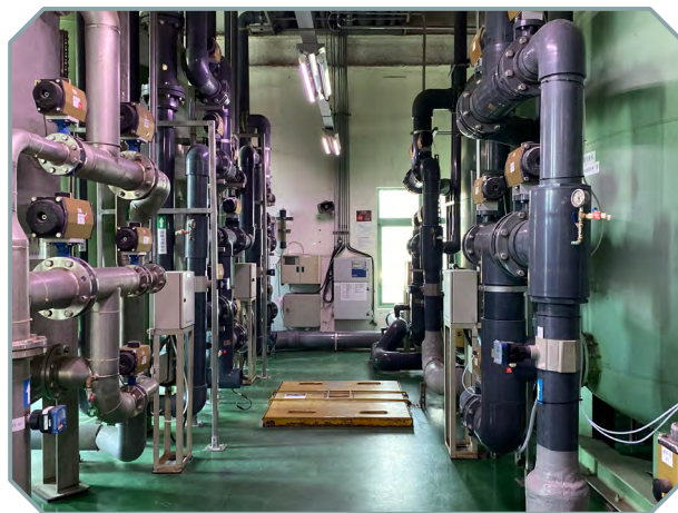
▲製程排放水回收系統
