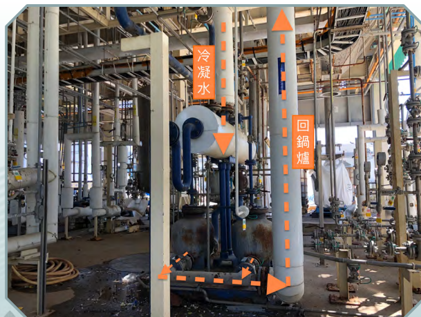
▲蒸氣凝水回收
