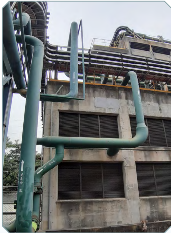
▲ 除礦水系統快洗水回收管
