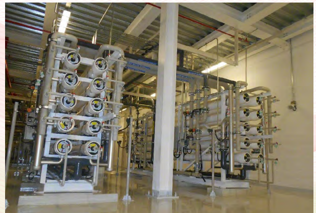
▲ 製程酸性廢水回收處理設備
