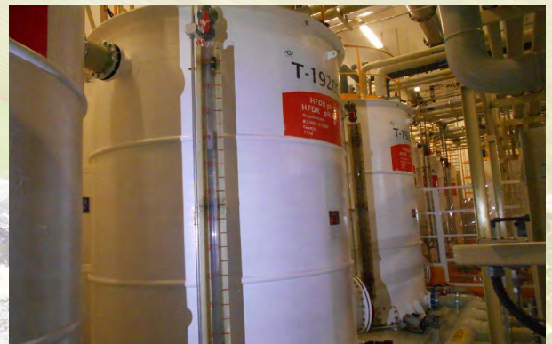
▲ 低濃度氫氟酸廢水回收處理設備
