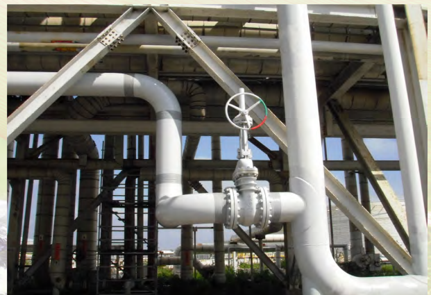
▲雨水再利用輸送管線
