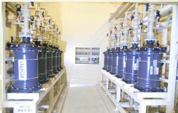
▲ 氨氮廢水薄膜處理設備
