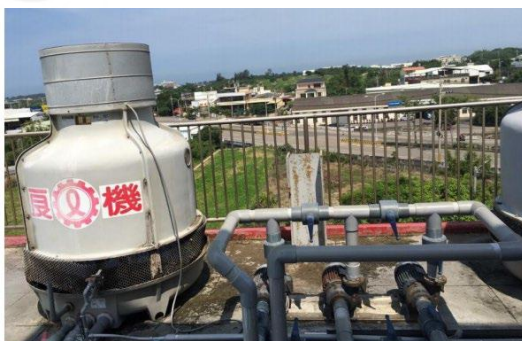
圖3-1 冷卻水塔(出風口加裝圍籬減少水噴濺)
