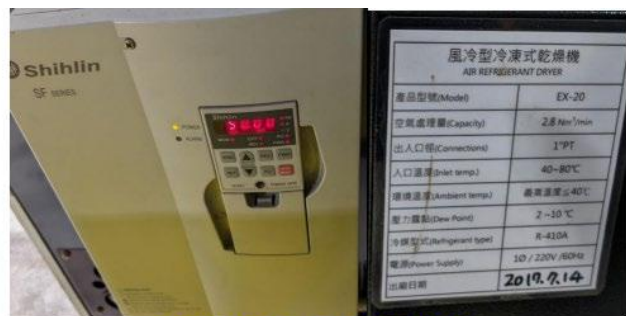
圖5-2 空壓機變頻器及冷凍式乾燥機
