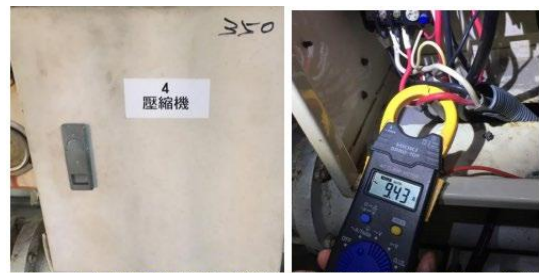
圖3-3 冷凍冷藏庫壓縮機耗電(220V*9.43A*1.732*80%(功因)=2.87kW)
