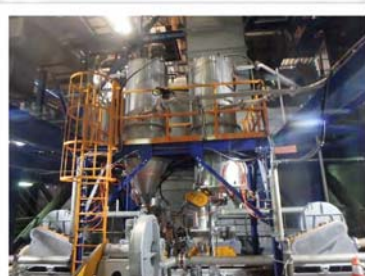
新除酸藥劑設備
