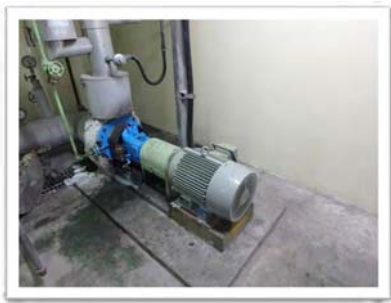
15HP NO.1 冷凝水泵馬達
