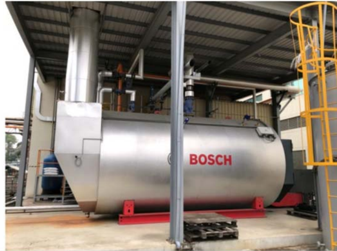
新設天然氣鍋爐 2019年1月正式啟用
