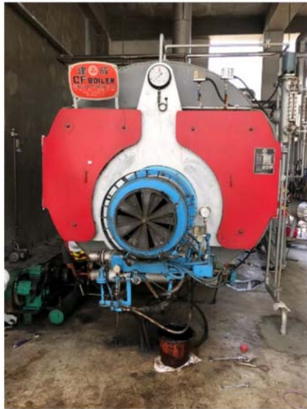
舊重油鍋爐 2018年9月已停用
