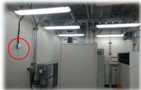
空調溫度感測器安裝位置優化(後)
