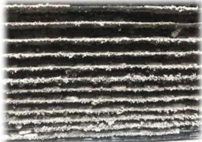
散熱材汰換前
