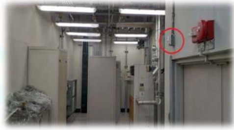
原空調溫度感測器安裝位置(前)
