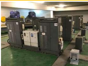
建置電梯電力回生裝置 節電11,827 kwh/年 減碳6.55噸/年
