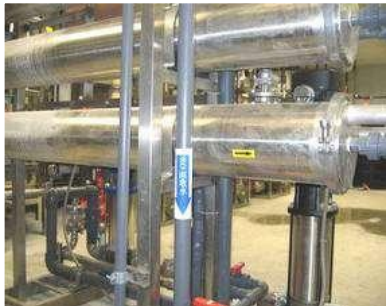
RO排放水回收
