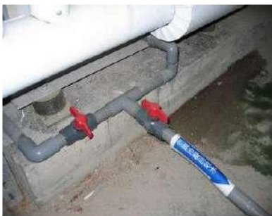
空調系統排放水回收
