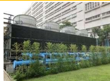
汰換冷卻水塔 節電21,5914kwh/年 減碳120噸/年
