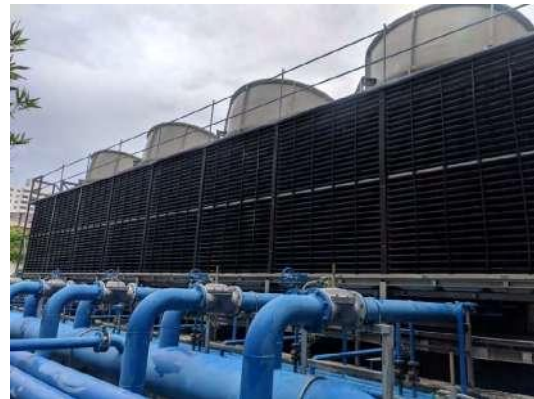
#1.2.5冷卻水塔外觀
