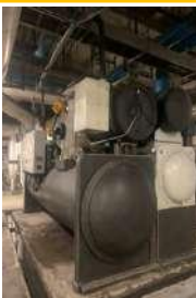
汰換儲冰空調系統 節電678,600kwh/年 減碳361噸/年
