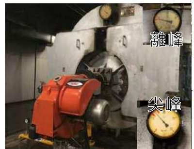
鍋爐離峰時段降壓供應
