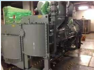
新建高效率冰水主機 節電1,542,240kwh/年 減碳854噸/年
