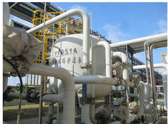
▲ 減少冷卻水塔旁濾系統補充水
