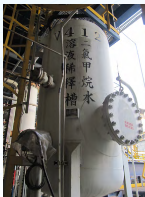
▲ 二氯甲烷水溶液槽減少排放
