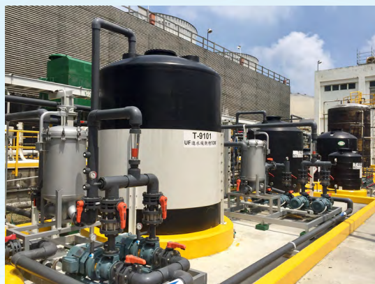
▲ 冷卻水塔排放水回收系統
