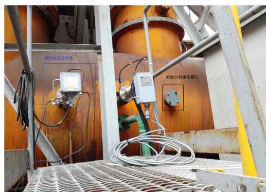
▲ 轉爐 OG 系統雷射氧氣分析儀設置
