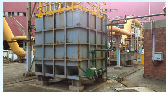
▲ 第一煉鋼高架水塔溢流水及增壓風扇軸承冷卻水回收蓄水池圖
