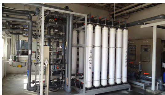
▲ 冷卻水塔排放水回收 (UF)
