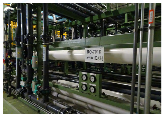
▲ 鹼性氨氮廢水回收系統 RO
