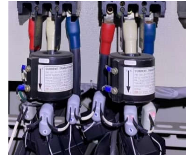
嘉義某塑膠公司 生產設備用電量測
