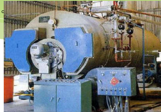
鍋爐冷凝水回收用於鍋爐再使用
