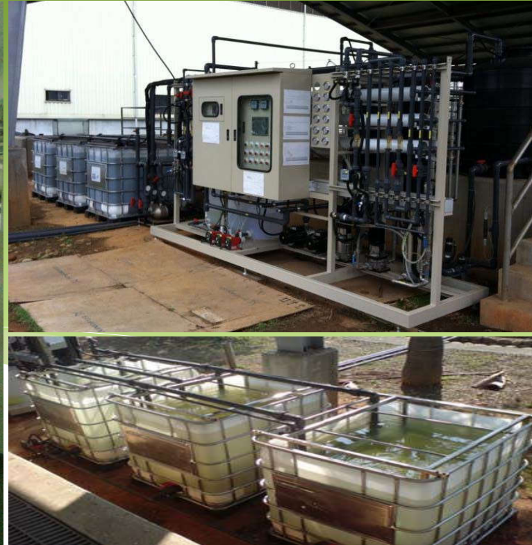
UF超過濾設備及待處理的廢水
