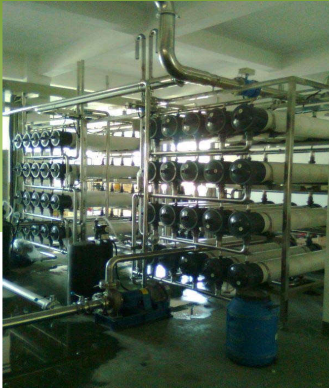
RO逆滲透設備
