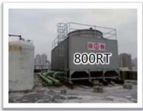
與SPC股 共用頂樓冷卻水塔
