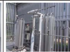
蒸發器之冰水回收提供電力機房空調箱使用
