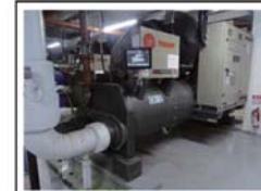
高效率冰水主機 性能係數COP=6.33
