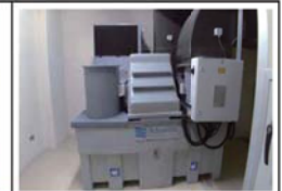
藥品庫房裝設 溶液除溼系統
