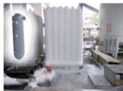
液氧槽蒸發器之冰水回收再運用
