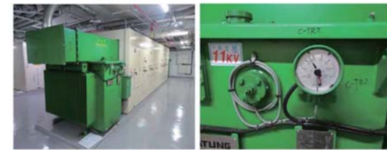
高效率非晶質變壓器
