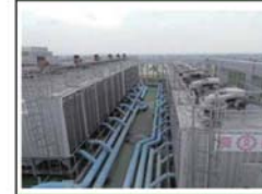
冷卻水塔風扇 裝設變頻器控制
