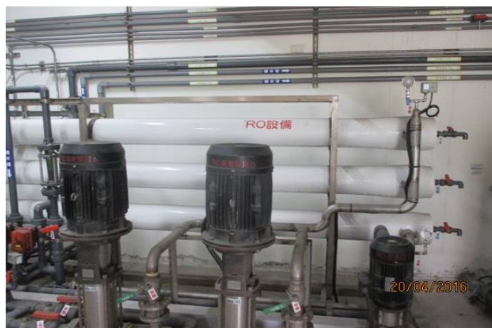
■ 圖 27 奈米過濾系統設備圖
