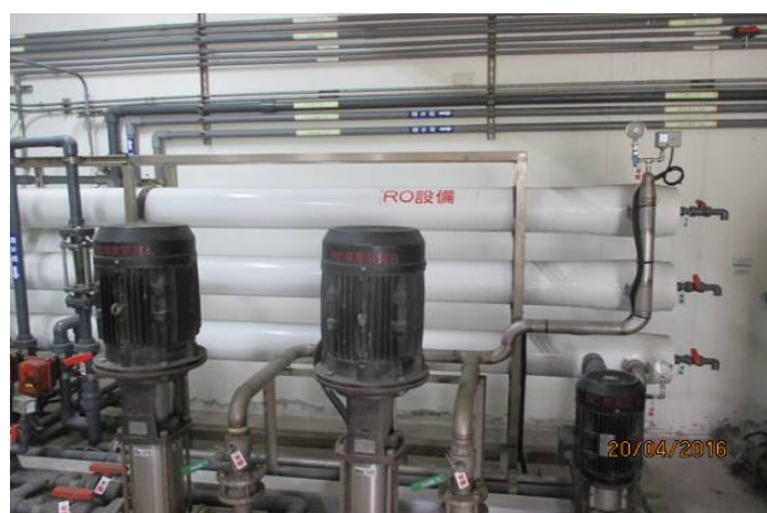
■ 圖 29 奈米過濾處理系統設備圖
