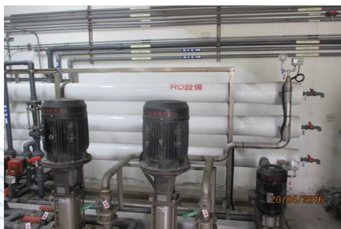
■ 圖 15 奈米過濾薄膜設備圖
