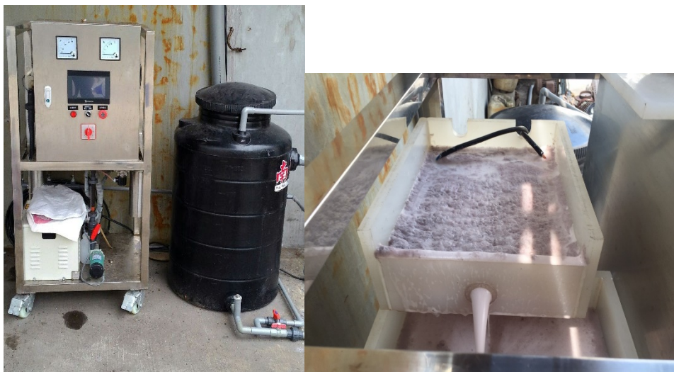
圖 31 電混凝處理系統實廠模組
