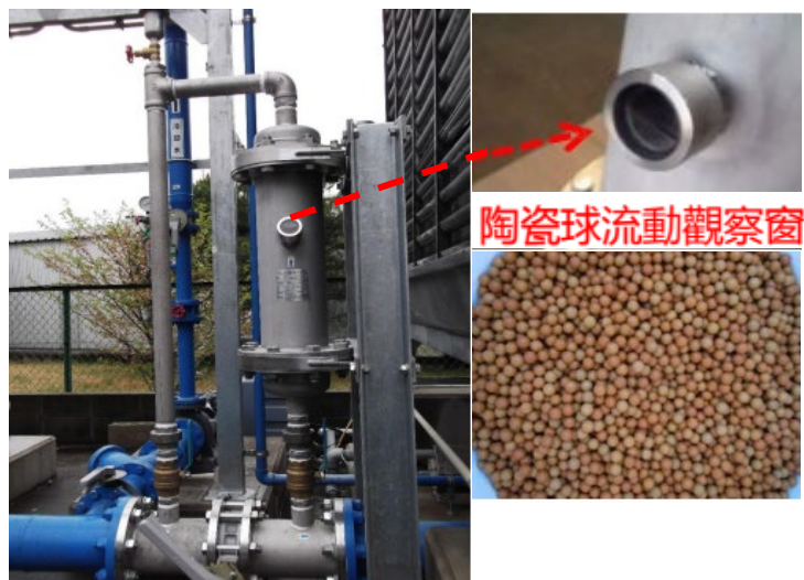
(資料來源：盛義實業，冷卻循環水處理裝置 EMIIR SRDEC-CT 提案書，2016)
