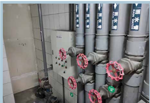
▲地下筏基雨水收集系統
