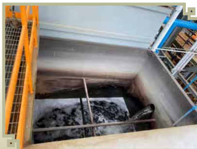
▲ HBF 設備清水槽
