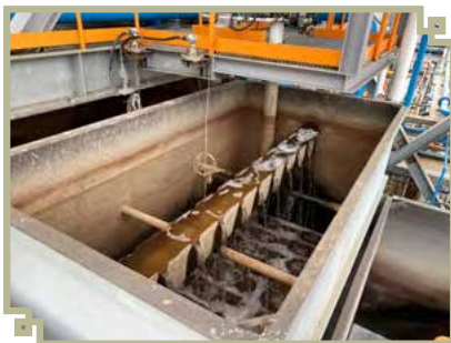
▲ HBF 設備深層過濾床
