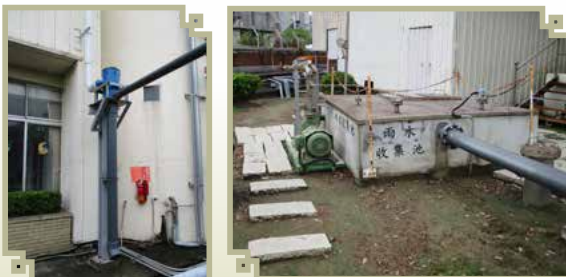
▲ 行政區域建築物雨水回收系統建置 (左) 雨水自動過濾器 (右) 雨水收集池
