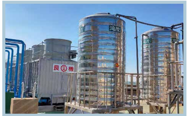
▲冷卻水塔整併新增導風罩減少噴濺並新增大水塔儲存回收水
