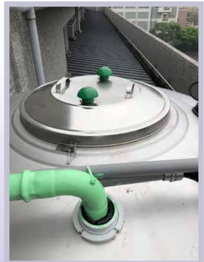
▲雨撲滿加裝防蟲網(綠色蓋子)外，也建置自來水補水裝置
