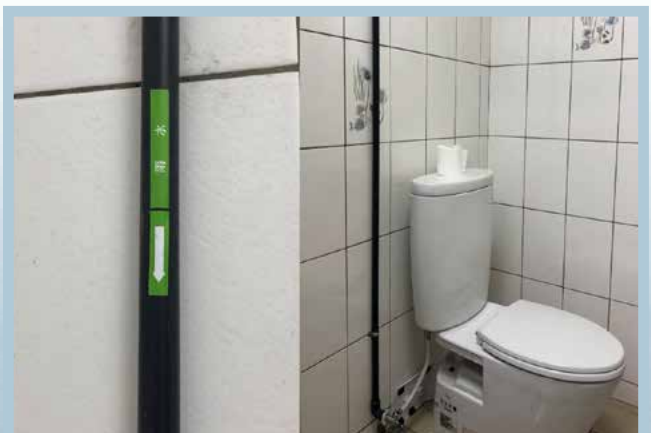
▲雨水收集於筏基過濾後供應馬桶沖洗
