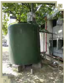
▲發貨中心旁儲酒雨水收集桶
