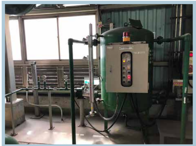
▲ 空壓二站空壓機冷凝水回收至冷卻水塔
