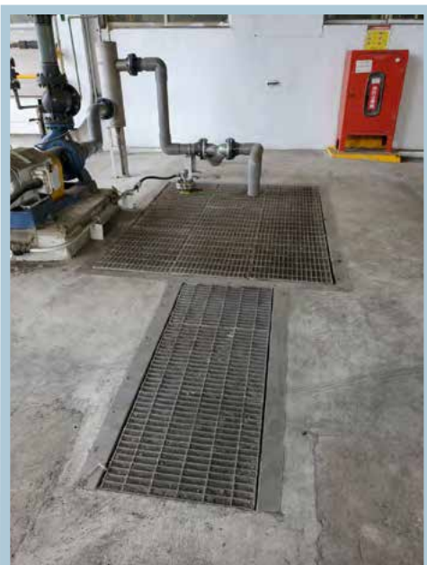
▲道路雨水收集 PIT-1
