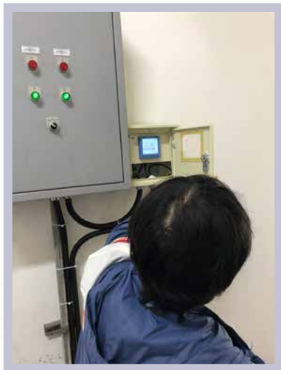
▲加裝數位水表了解進水及出水情形
