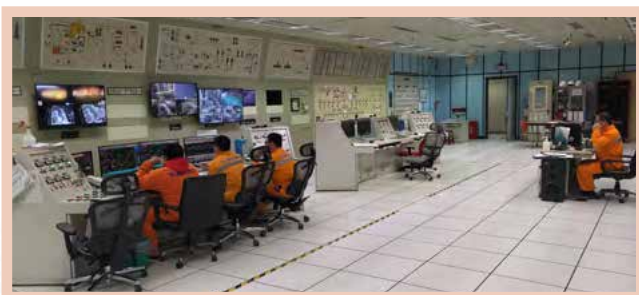
▲穩定操作減少非計畫性停機次數 - 中控室 DCS 系統更新
