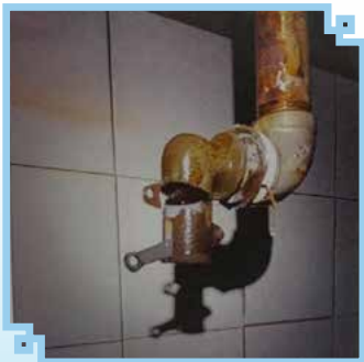
▲ 改善前 ( 高壓浮球開關破損 )
