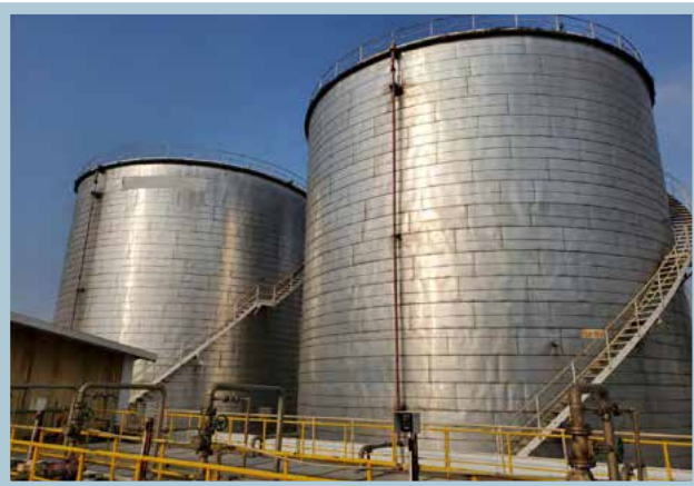
▲ 3000 噸暴雨收集儲槽 (2 槽)
