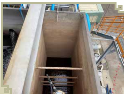
▲ HBF 設備汙水槽
