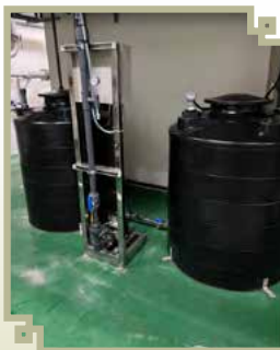
▲ 回收槽及輸送設備
