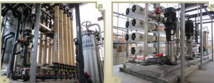
▲ 公用一場冷卻水 Blow Down 回收系統工程 (左) UF 系統 (右) RO 系統
