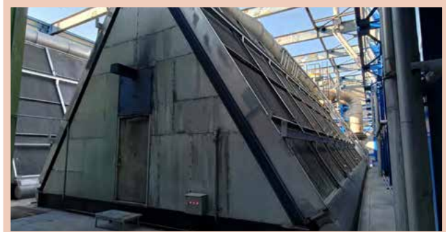
▲改善氣冷式冷凝器 (ACC) 系統 - 右側
