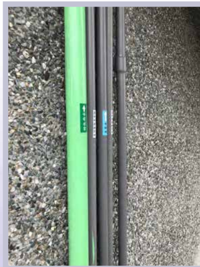
▲雨水管與一般水管分色及標示清楚水流方向
