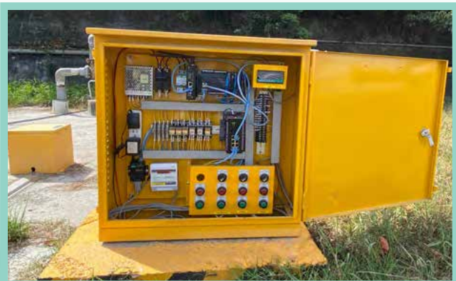
▲可程式邏輯控制器：可對水撲滿馬達下達啟動及停止之指令，另可將水撲滿庫容之資訊回傳至中控電腦，以便遠端查看。
