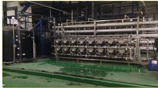
RO離線藥洗模組
