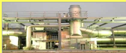
製程廢氣處理系統
