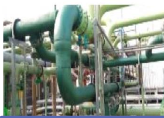
新增熱交換銜接管路
