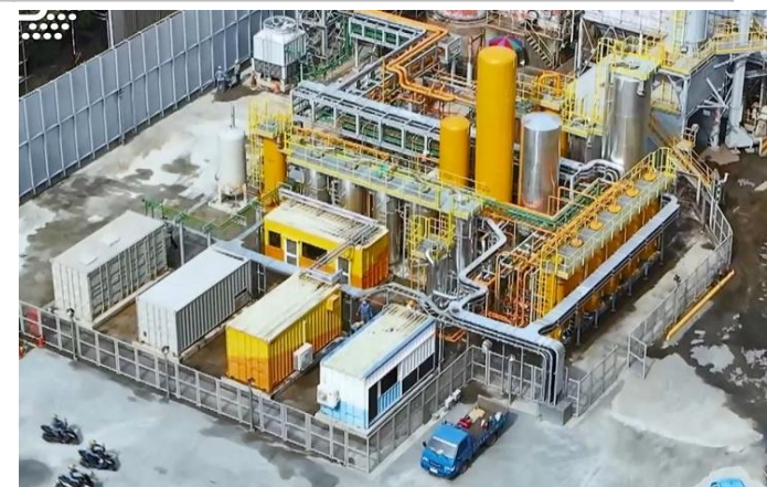
中鋼 - 鋼化聯產先導工廠
