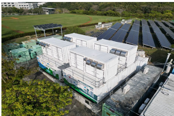
液流電池 ，工研院六甲院區使用堆疊方式，上面為電堆貨櫃，下面為電解液桶槽
