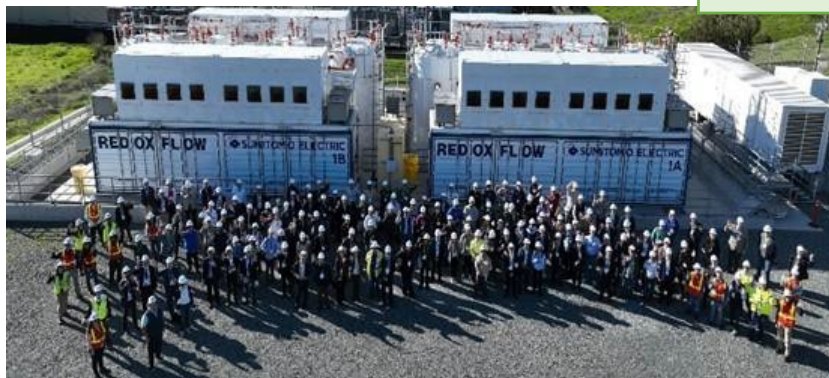
液流電池 ，日本住友電工在美國聖地牙哥2MW/8MWh NEDO示範場域
