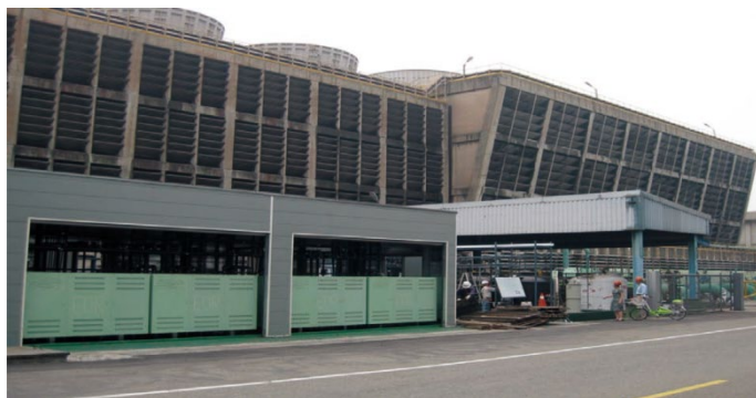
中鋼公司EDR實廠照片
