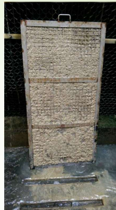
冷卻水塔濾網
