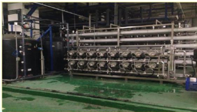
RO離線藥洗設備
