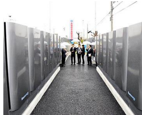
大阪府中央卸売市場 1.2 MW(market)
