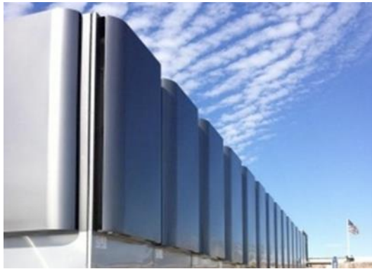
Delmarva Power 30MW 發電廠(power plant)
