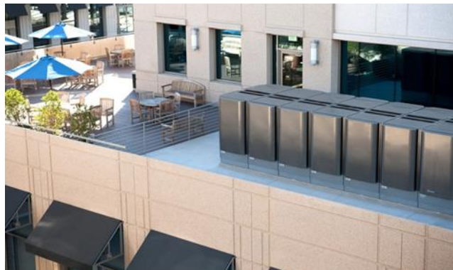
Nokia 500 kW 辦公大樓(office)
